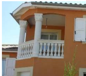
Type de balustres interdites
